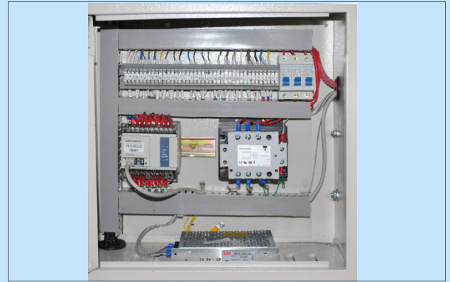
控制電箱 Electric Control Box
