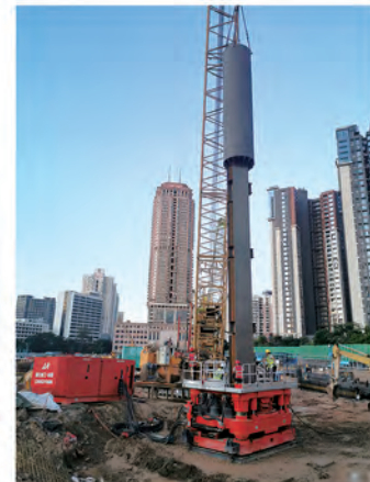
钢立柱高精度垂直插入施工 High precision vertical insert the steel column
